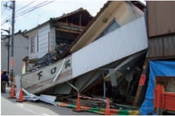
全壊した店舗（地震直後）
