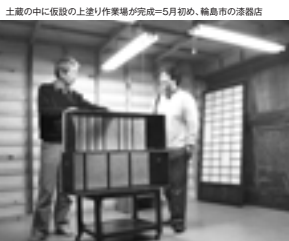
土壌の中に仮設の上塗り作業場が完成=5月初め、輪島市の漆器店
