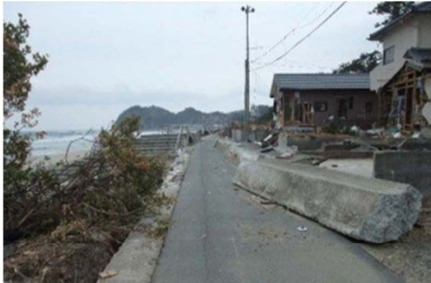
海岸護岸：パラペットの破壊
