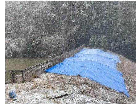
ため池堤防の崩壊 (輪島市小伊勢)
