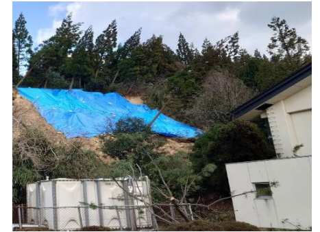
山腹崩壊 (珠洲市正院町川尻 正院小裏山)
