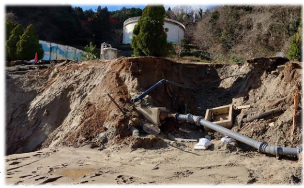
浄水場の被災
