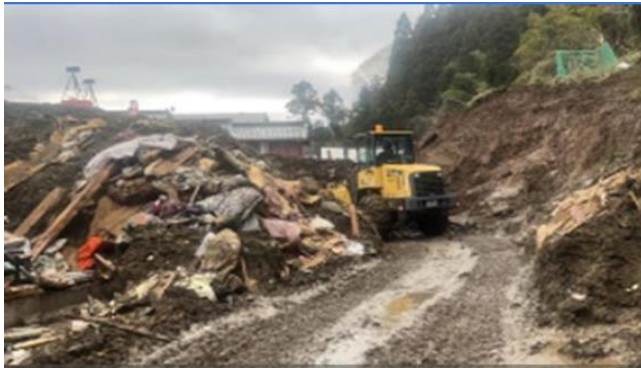
珠州市大谷町における道路啓開
