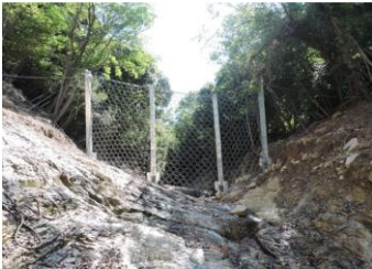
安全対策(ワイヤーネット)
