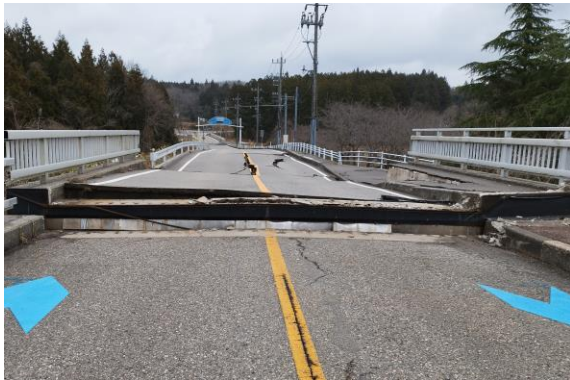
約40cmの段差が発生
