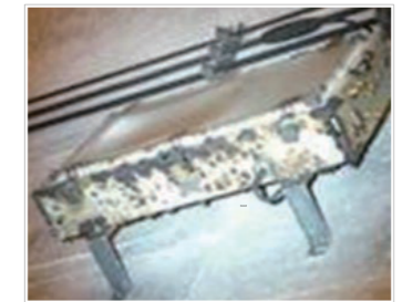
▲照明設備の腐食状況
