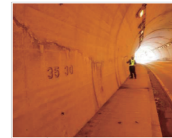
▲覆工コンクリートのひびわれ
