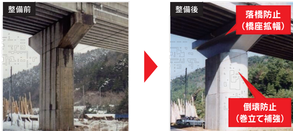
▲のと里山海道(七尾市中島町北免田 熊木川橋)
