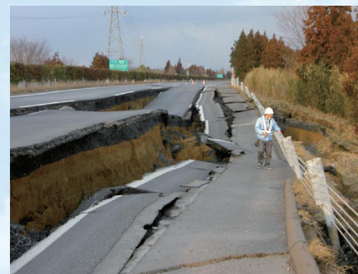
東日本大震災における常磐自動車道(水戸IC～那珂IC)の被災状況 (提供: NEXCO東日本)
