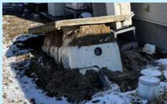
地震により浮き上がった浄化槽
