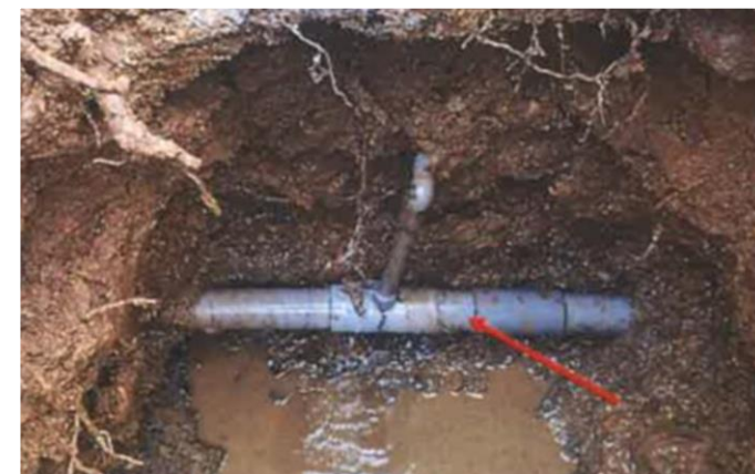
破断した水道管
