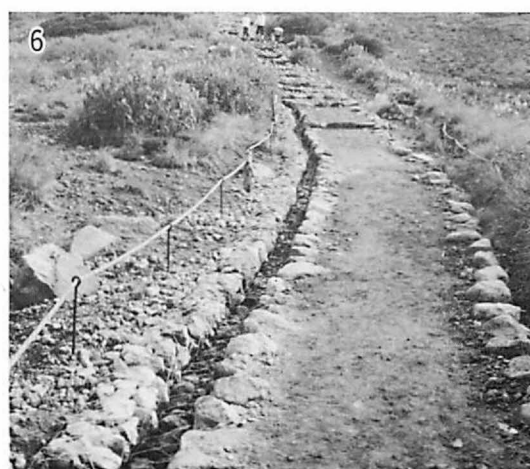
蛇籠排水工・保護棚工
