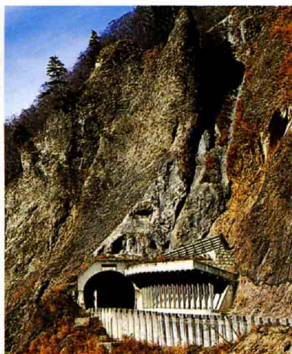
第5トンネル（第一ヘアピン附近）の断層
