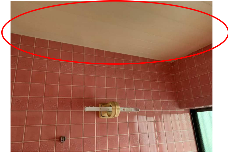
アスベストあり
