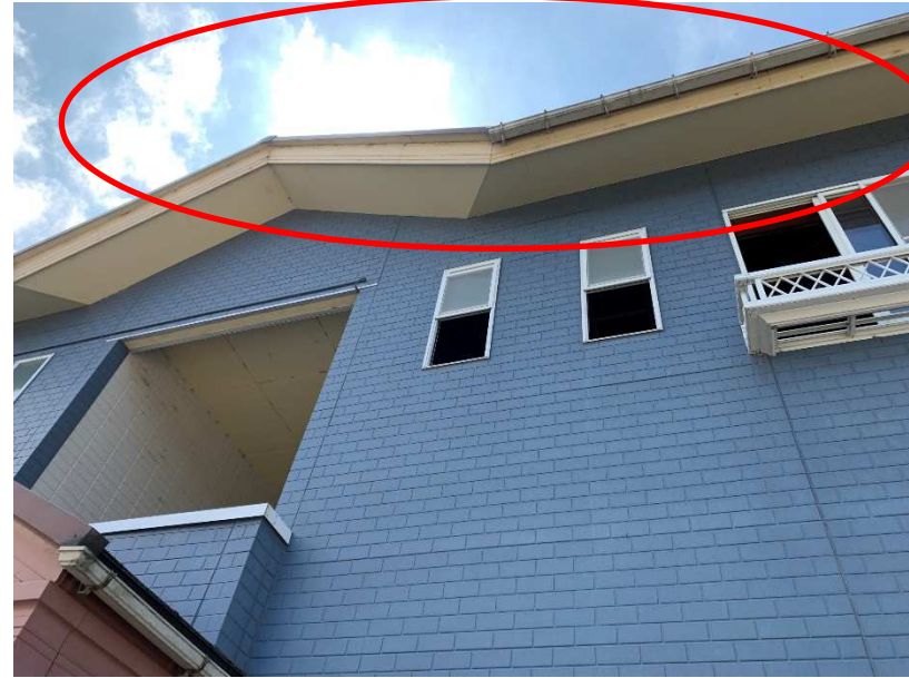
アスベストあり
