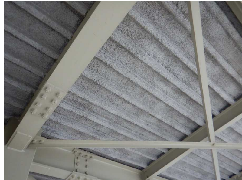
アスベストあり
