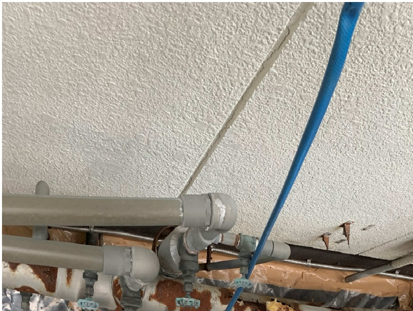
アスベストあり
