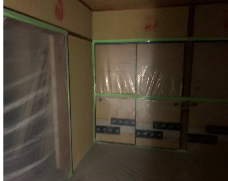
アスベストあり
