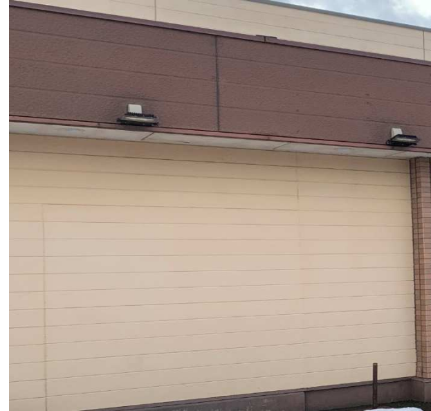
アスベストあり
