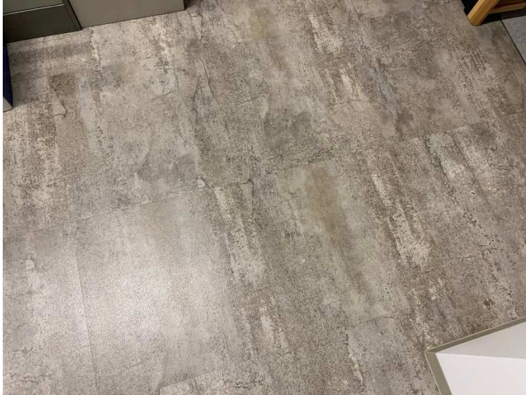
アスベストあり
