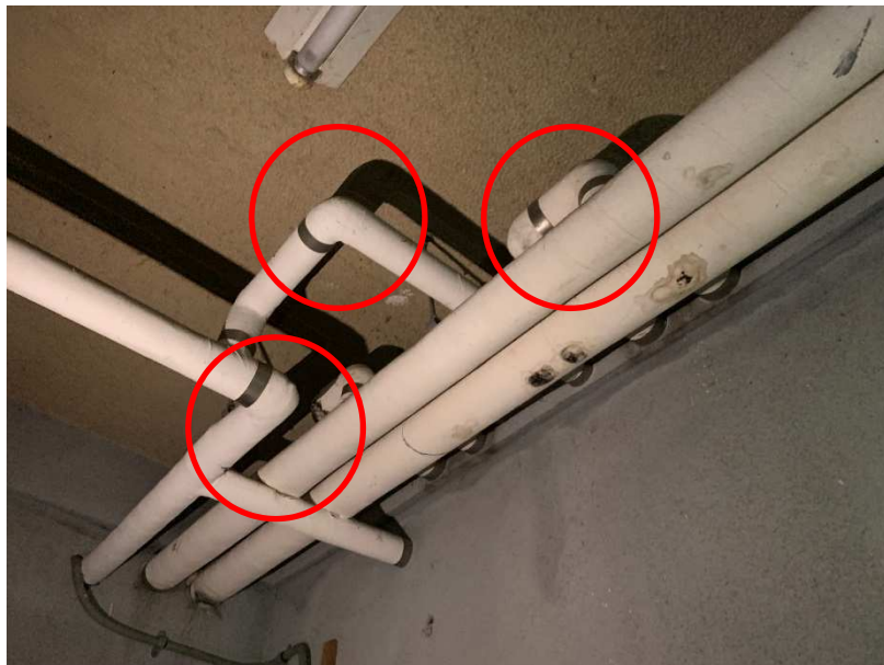
保温材アスベストあり（エルボ部分）
