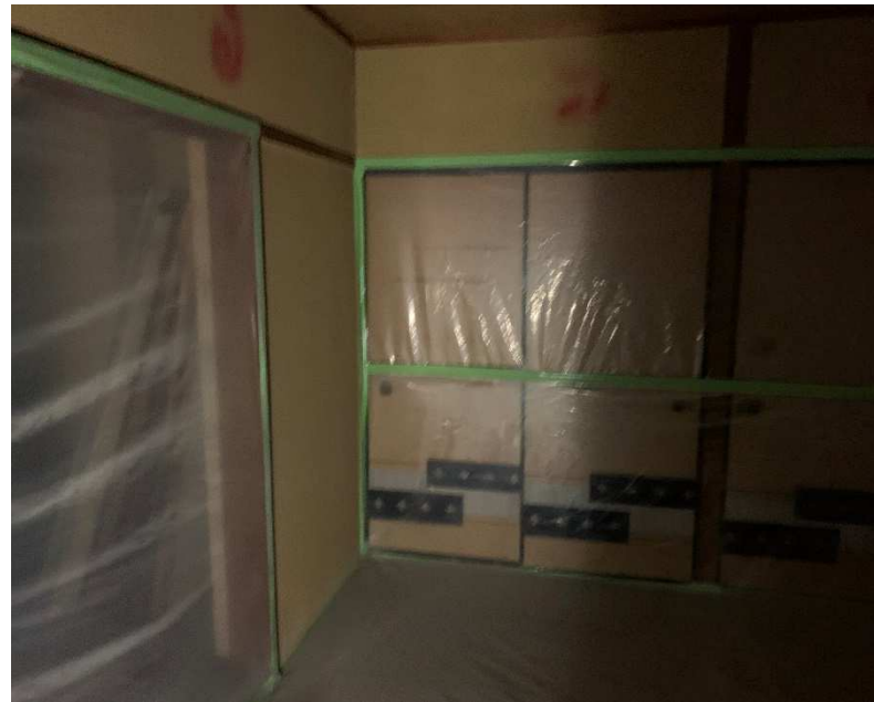
アスベストあり
