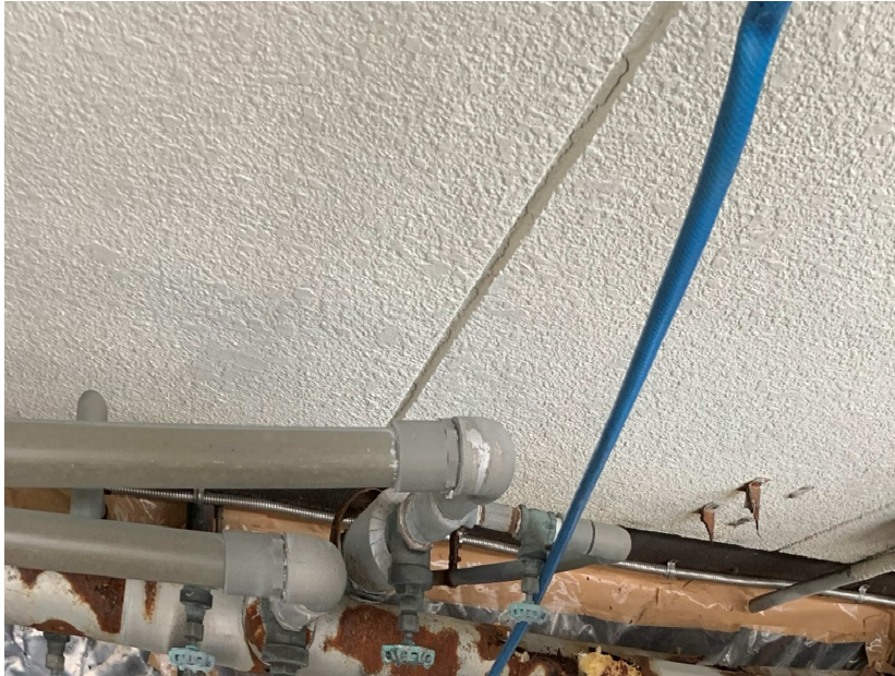
アスベストあり
