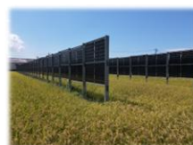
▲垂直型太陽光発電設備
