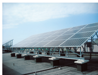
太陽光発電設備
