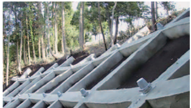
地すべり防止用アンカー
