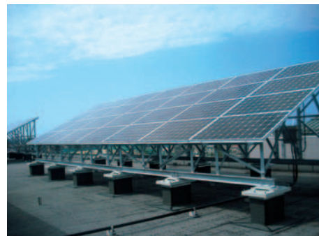
太陽光発電設備
