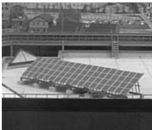
県庁舎の太陽光発電システム
