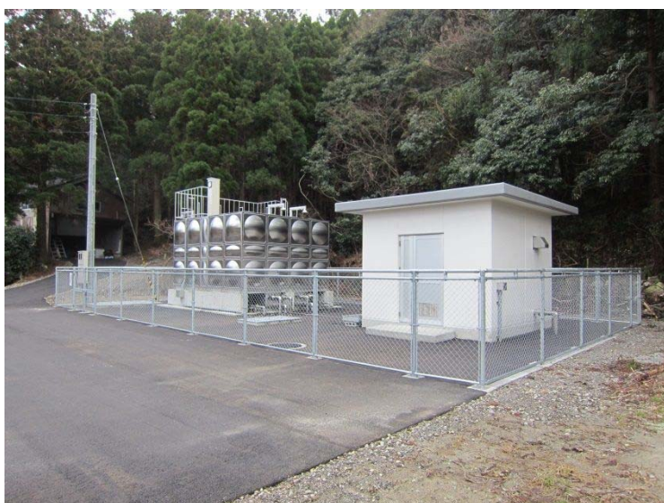
清水簡易水道真浦低区配水池(写真提供:珠洲市)
