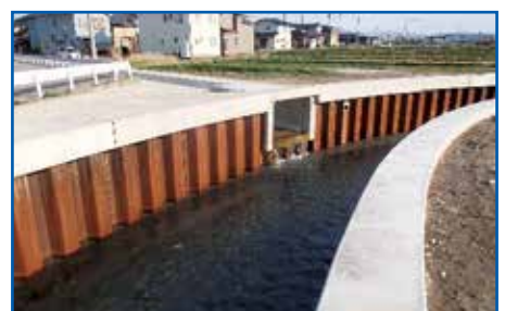
雨水排水施設（白山市 横江雨水排水幹線）
