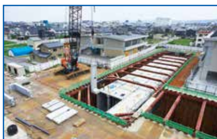
雨水貯留施設（金沢市 鞍月小学校）
