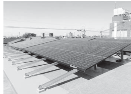
太陽光パネルの陸屋根設置例
