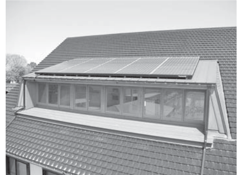
太陽光パネルのトタン屋根への設置例
