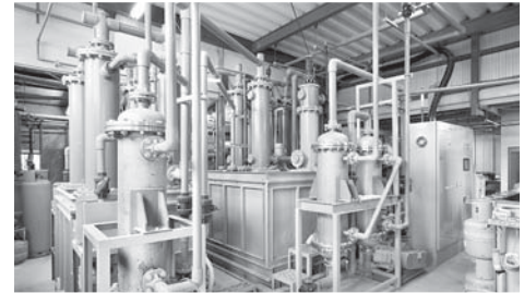
H25.1 に設置した破壊装置 2 号機
