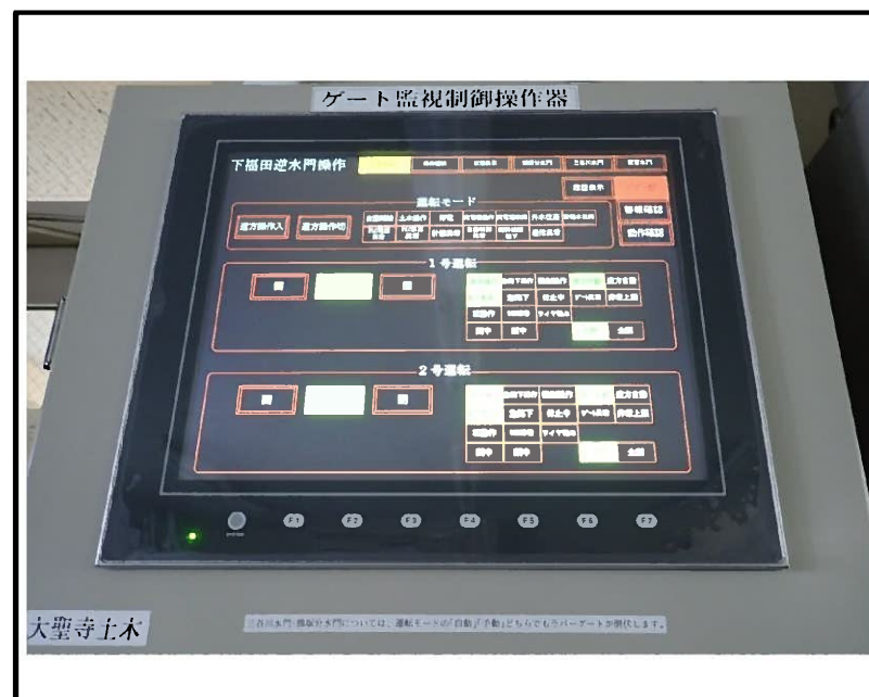
遠隔操作設備
