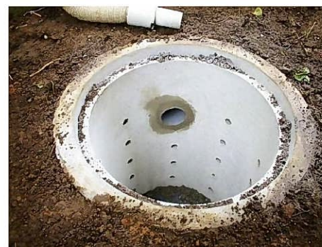
雨水浸透ます
