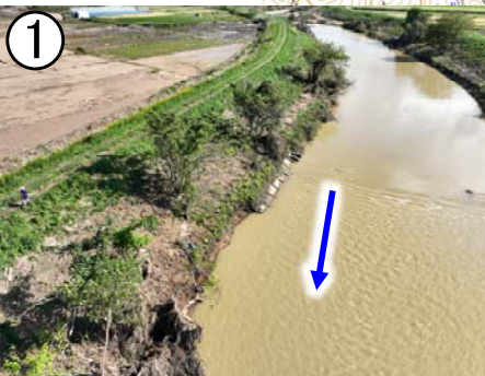
護岸の被災状況(町野川)
