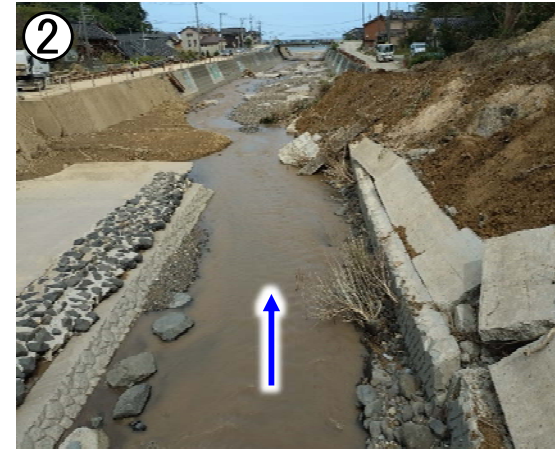
護岸の被災状況
