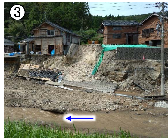
護岸の被災状況
