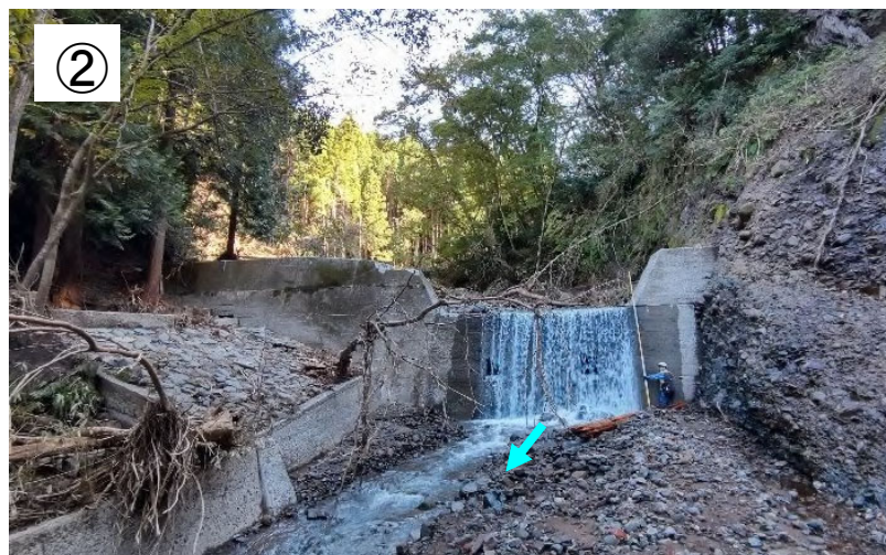
既設砂防堰堤が一部被災
