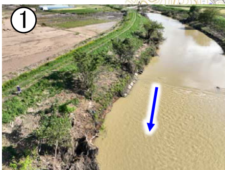
護岸の被災状況(町野川)
