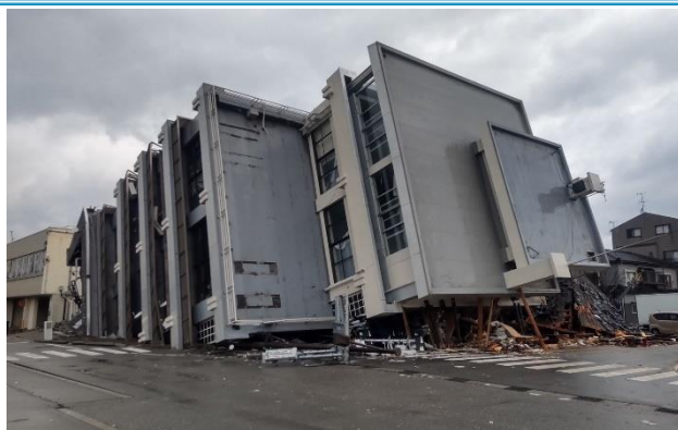
建物倒壊（輪島市河井町地内）
