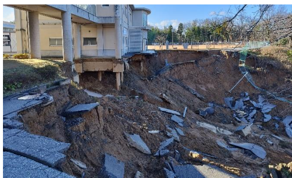
法面崩壊（金沢北陵高校（金沢市））
