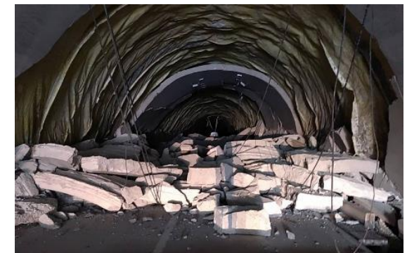
トンネル崩壊（国道249号）
