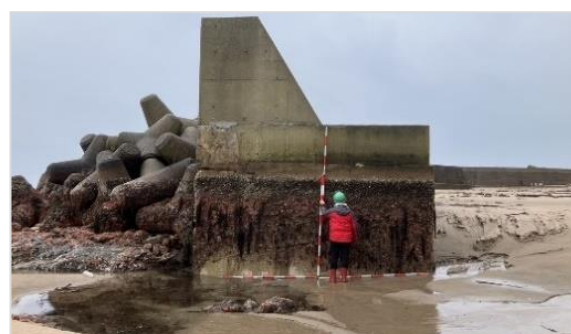
地盤隆起（鹿磯漁港（輪島市））
