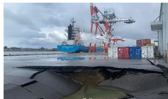
ふ頭用地陥没（金沢港（金沢市））
