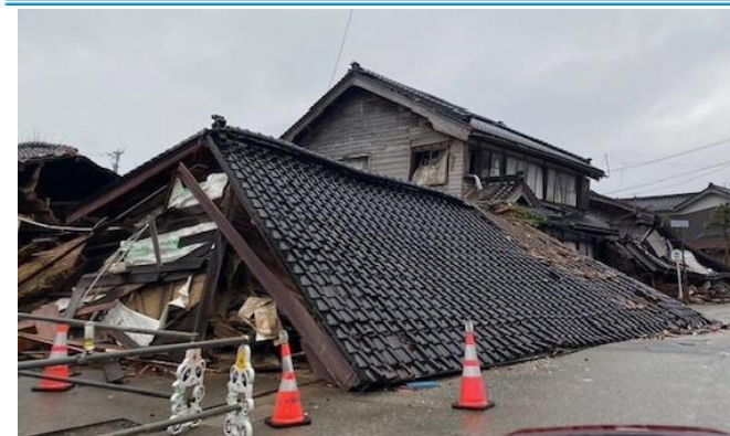
家屋倒壊（珠洲市三崎町地内）
