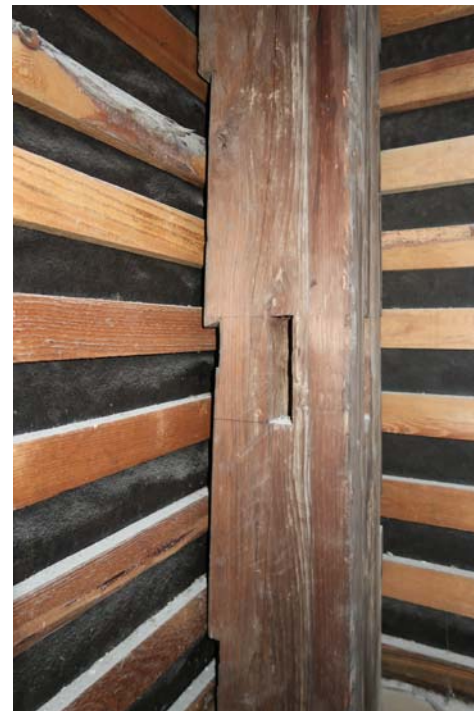
下見板が取り付けられた痕跡
