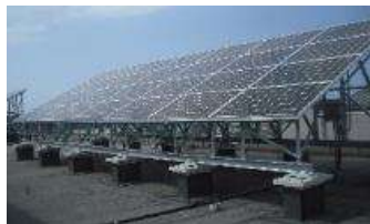
公共施設の屋上に設置した太陽光発電施設
