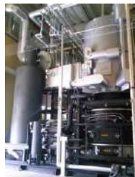
バイオマスボイラー
