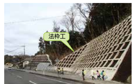
法面落石対策 [(主) 能都内浦線]
