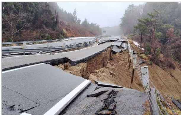
のと里山海道の被災状況
