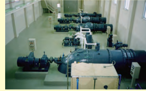
今江湯排水機場
