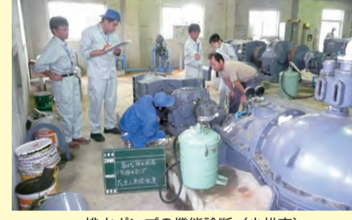
排水ポンプの機能診断 (小松市)
