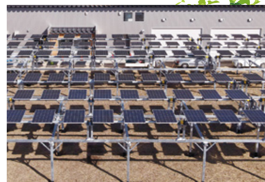
園内に設置される太陽光パネル
