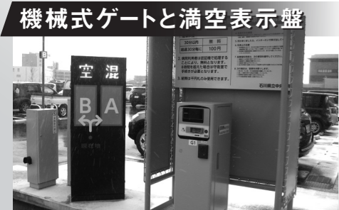
機械式ゲートと満空表示盤 ゲート管理による駐車場の適正管理と混雑状況の表示による利便性の向上
