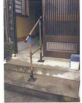
プラン1 ① 玄関 手すり①
