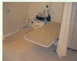
便器の横に高さ調節式のベッドを設置し、介助軽減または自立度の向上を目指した便所です。
