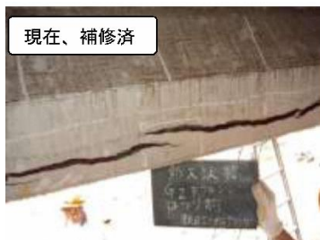
塩害劣化橋梁
