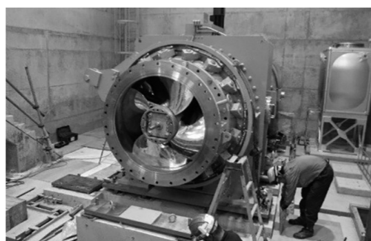
水車内部の様子
