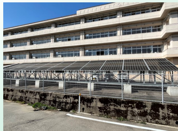
津幡中学校 出力20kW +蓄電池
