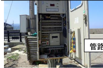
管路施設 制御盤
