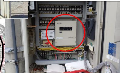
管路施設 遠方監視装置
