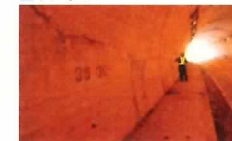
▲覆工コンクリートのひびわれ
