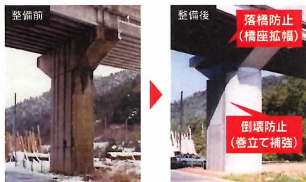
▲のと里山海道(七尾市中島町北免田 熊木川橋)
