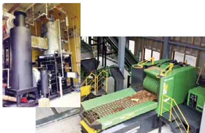
木質バイオマスボイラー及びチッパー(小松市)
