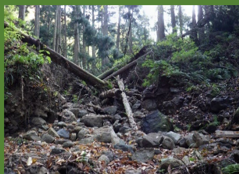
縦横浸食により谷筋で倒木が発生 (小松市)
