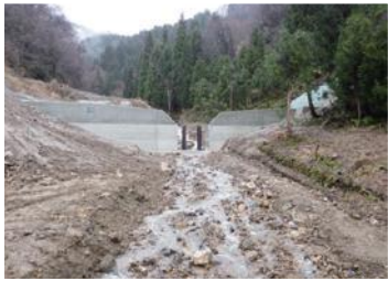
流木の流入防止 (白山市木滑地内)
