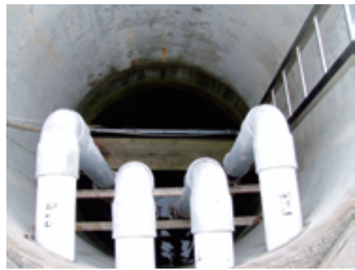
取水柵と給水管
