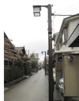
柱状式の地上機器を採用 (里見町／金沢市)
