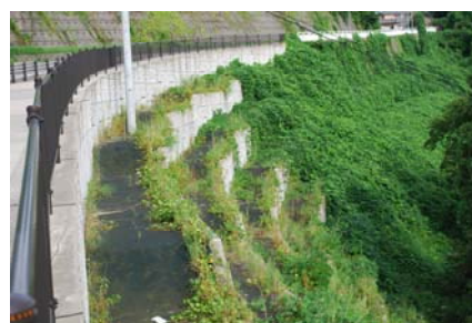
盛土部はテールアルメ擁壁を階段施工し、小段部へ植栽（一般県道芝原石引町線／金沢市）
