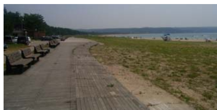
高低差を活かし、後浜に水平線を眺望できる視点場として水叩き工（ボードウォーク）を整備（富来漁港海岸／志賀町）
