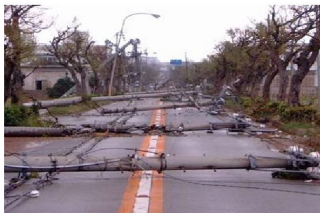
台風被害による電柱倒壊状況
